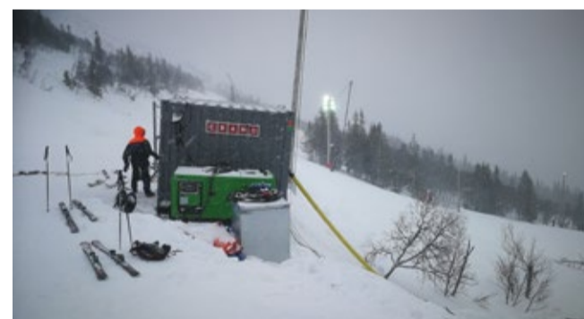
Equipo técnico de K&Be Power AB controlando el sistema grupos electrógenos – SAI
