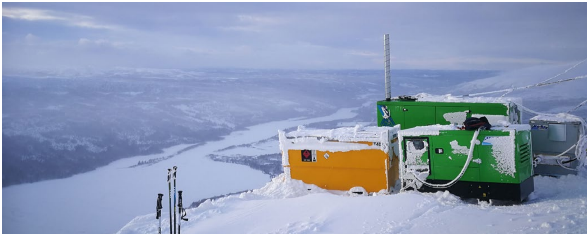
Grupo electrógenos en emergencia uno en reserva del otro
