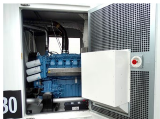
Vista del interior de la puerta de acceso con dispositivo de emergencia desde el interior.
