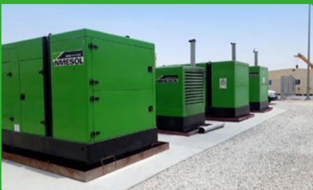
Grupos electrógenos INMESOL suministrando energía las 24 horas para la construcción del estadio
