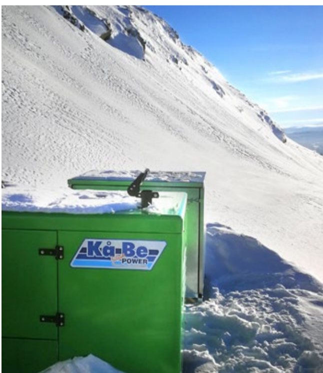
Grupos electrógenos en emergencia, uno en reserva del otro, en un área sin red eléctrica
