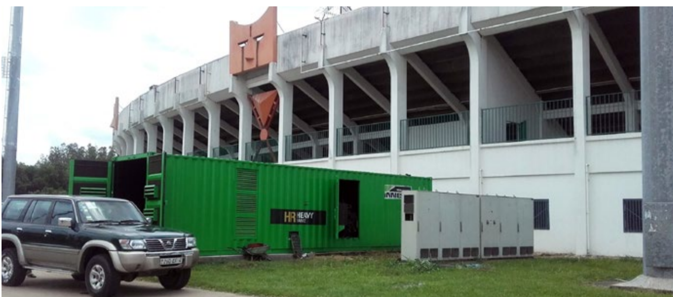
Grupo electrógeno IP-1135, con doble panel de insonorización
