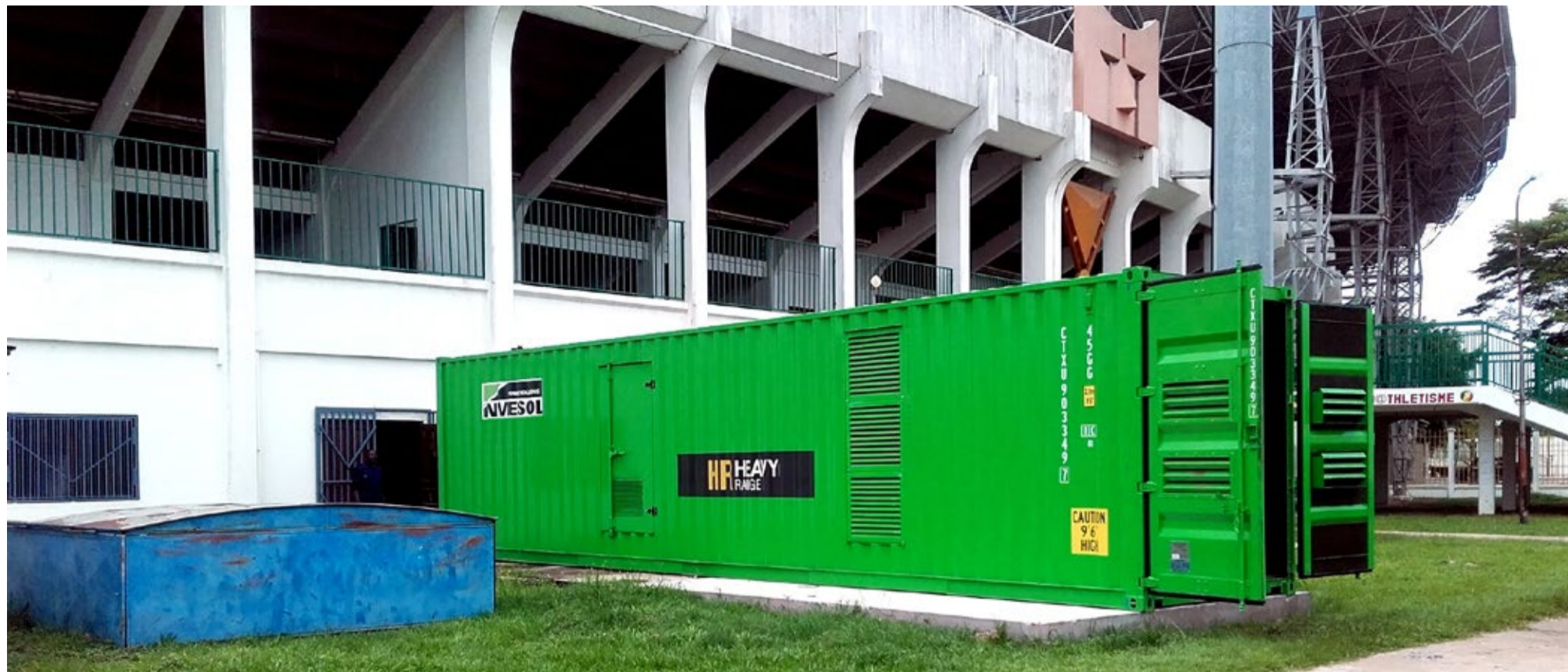
Grupo electrógeno en emergencia INMESOL modelo IP-1135
