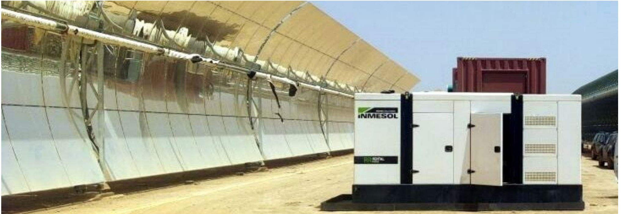
Grupo electrógeno en emergencia INMESOL modelo IVR-440
