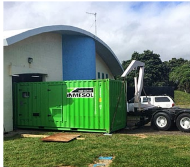
Grupo electrógeno modelo IT-1115 entrando en la sala de la estación de bombeo
