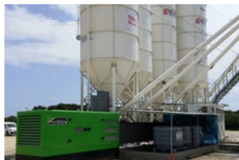
Grupo electrógeno de 440 kVA LTP en la central de hormigón ubicada en el Centro Espacial Guayanés
