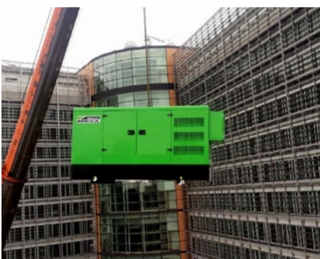
Grupo electrógeno en emergencia INMESOL modelo II-110, elevándose hasta el tejado del Berlaymont
