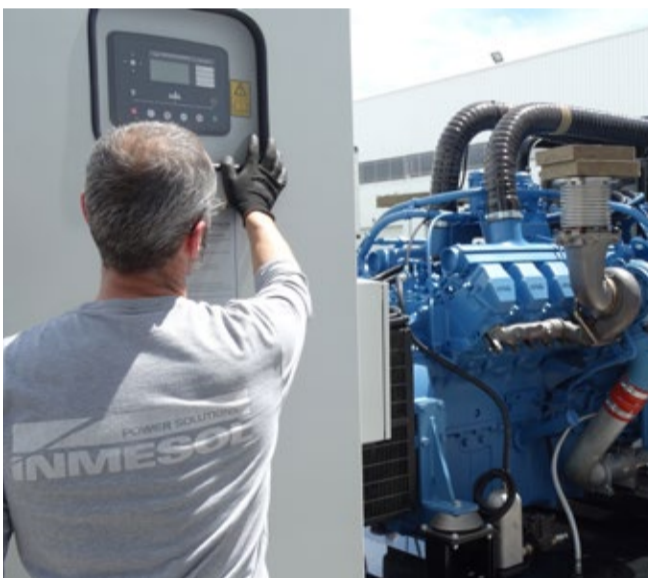
Generador INMESOL con DSE 7320 MKII
