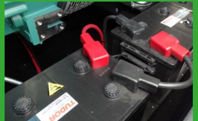
Baterías que arrancan el motor del grupo electrógeno
