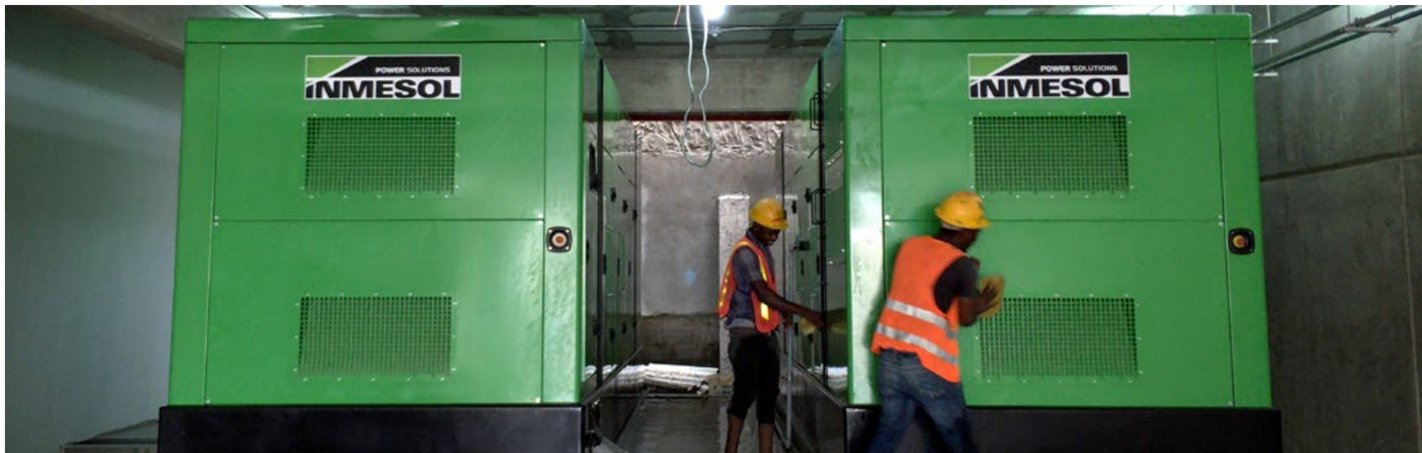
Las dos plantas eléctricas de 1010 KVA LTP recién instaladas en el sótano del Hospital Central Las Colinas.
