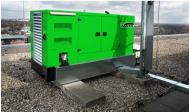
Grupo electrógeno INMESOL IV-110 instalado en la azotea del centro de negocios
