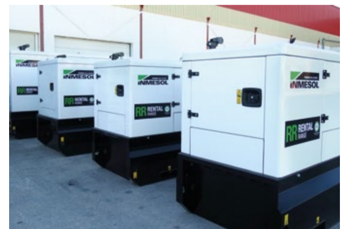
Grupos electrógenos Rental trabajando en paralelo
