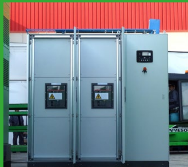
Cuadro de conmutación de 2500 A, que permite el funcionamiento sincronizado entre los dos grupos con la red.
