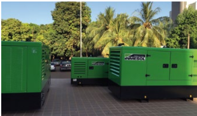
Grupos electrógenos IP-014, IP-0 50 e IP-066.
