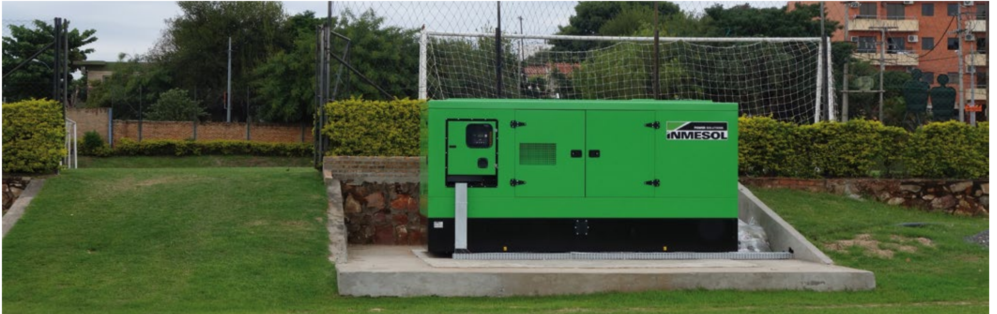
Grupo electrógeno INMESOL mod. II-440 instalado dentro del recinto deportivo del estadio "Dr. Nicolás Leoz", Asunción, Paraguay
