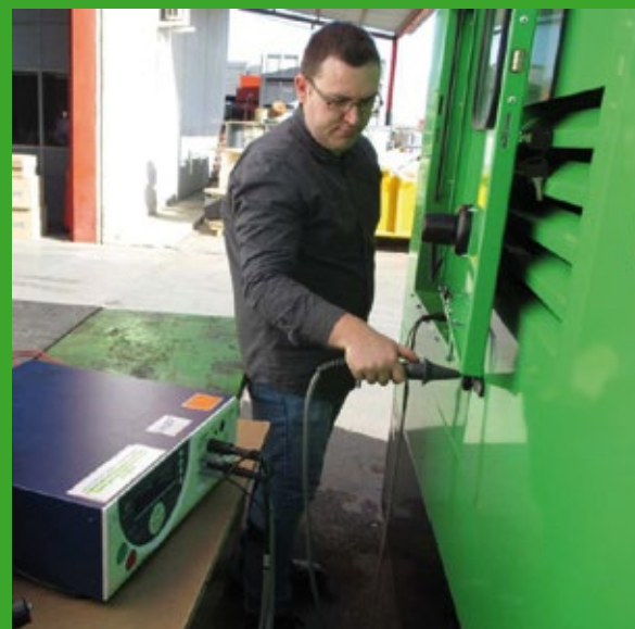
Toma de medidas entre las distintas partes metálicas de la envolvente del grupo electrógeno y el borne principal de protección
