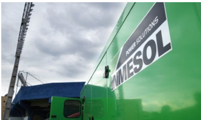
Grupo electrógeno mod. II-440 junto a los focos que alimenta.
