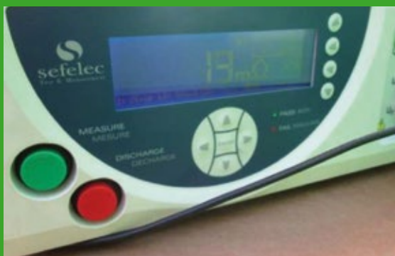
Lectura de la resistencia entre el borne principal de protección y la envolvente derecha de un grupo electrógeno.
