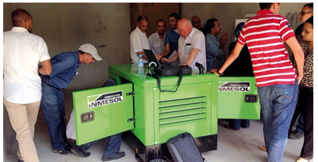
Ing. Hakan Ericsson transmitiendo la programación desde ordenador a la central de control del grupo electrógeno
