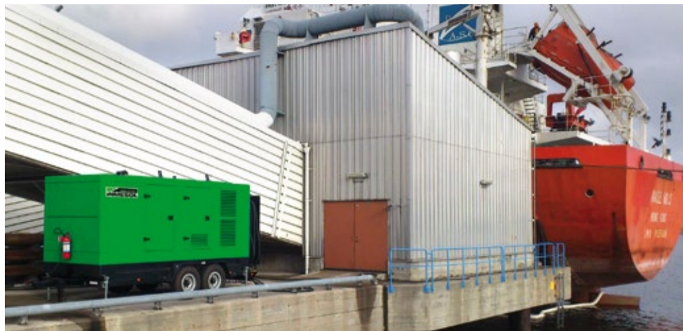
Grupo eléctrico Inmesol en uno de los puertos de Estocolmo
